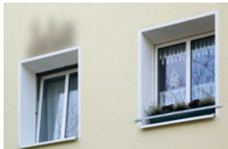
Unschöner Anblick: Ein stets gekipptes Fenster sorgt übrigens an den Außenwänden des Hauses, direkt über dem Fenster, für Algenbildung.
