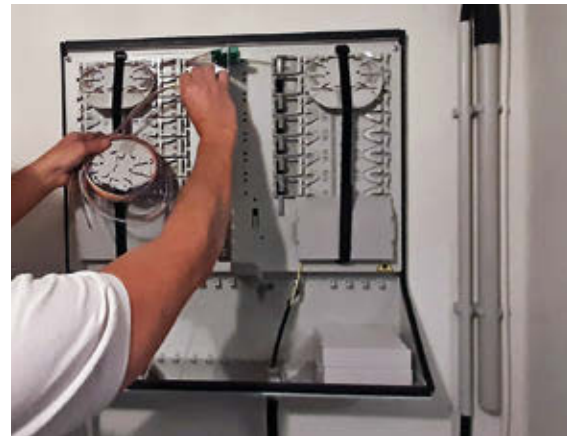
Über diesen Glasfaser-Hausanschluss wird das High-Speed-Internet in die Wohnungen geführt
